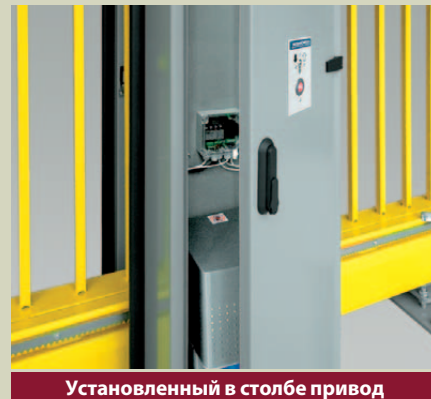
Установленный в столбе привод
